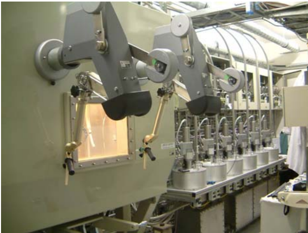
Abb. 1: Blick in den Handhabungsraum der Bestrahlungsrohrpost RPA
